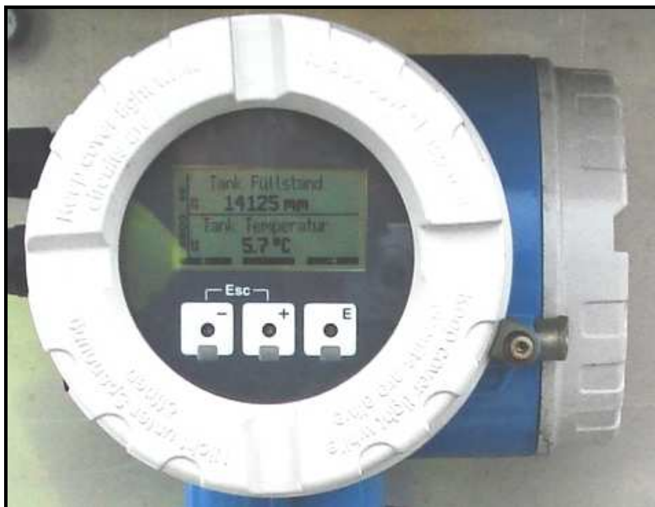
Figura 14 – Leitura de nível e temperatura e ATG/ATT
