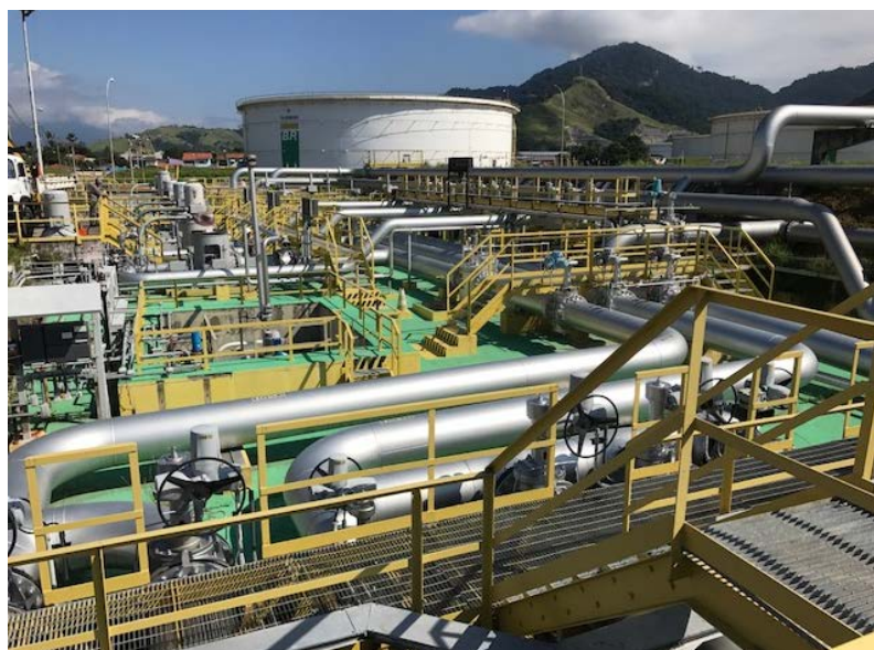
Figura 13 – Manifold de terra e bombas Booster .
