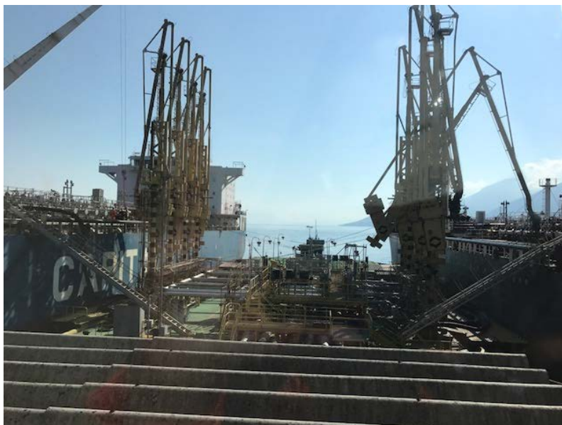
Figura 12 – Manifold e braços de carregamento atuais do Píer Norte.
