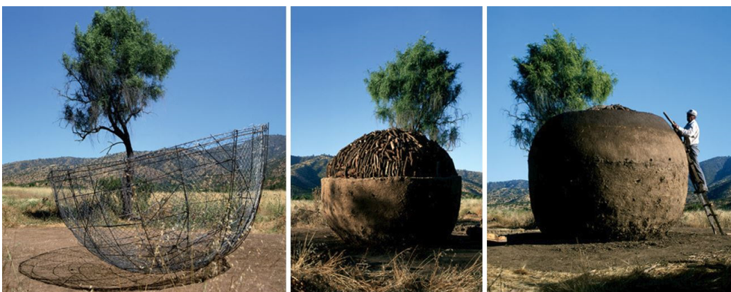
Figura 34: Ampliación para la Casa del Carbonero – Processo construtivo. Fonte: El Croquis n.167 - Smiljan Radić: 2003-2013, p. 12.
