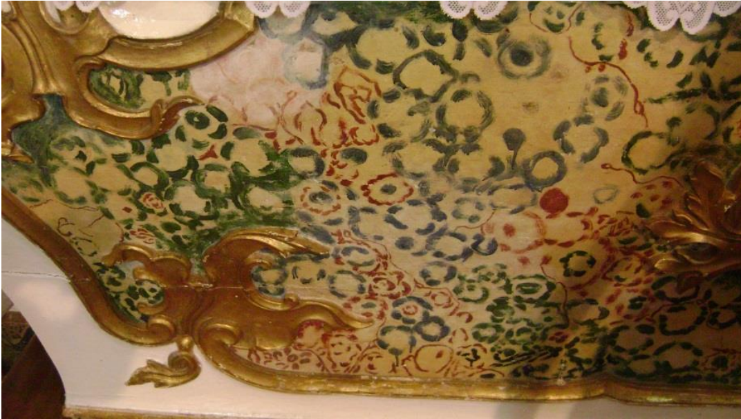
Figura 27 – Detalhe da aplicação das lantejoulas na decoração da mesa da capela-mor. Igreja de Nossa Senhora da Conceição, Carrancas. Foto: Maria Cristina N. de Azevedo, 2011.
