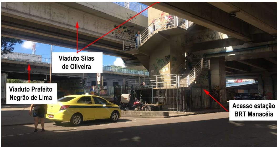
Figura 39: Vista do viaduto Silas de Oliveira e da escadaria de acesso à estação BRT Manacéia, na rua Francisco Batista
